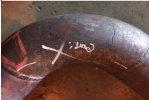
Gambar 1 Crack pada elbow 90°
