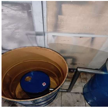
Gambar 3.7. Proses pembuatan pipa sambungan
